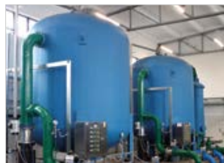
Mrągowo Stacja Uzdatniania Wody dla miasta Mrągowo
